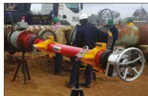
▲ Работы по выполнению горячей резки с помощью СНТ3000 для установки нефтехимического трубопровода.
